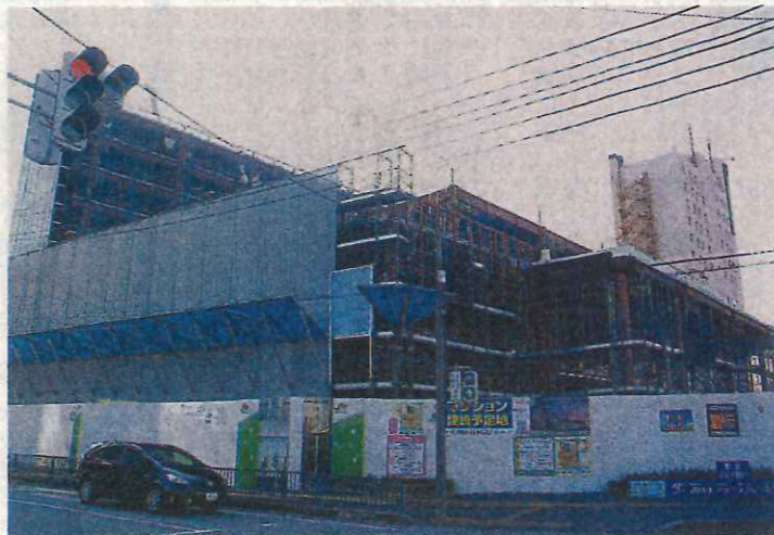
北東側（駅正面）から見る駅周辺整備事業の建設現場。手前がライブラリーセンターなど、左奥がホテル＝昨年12月末
