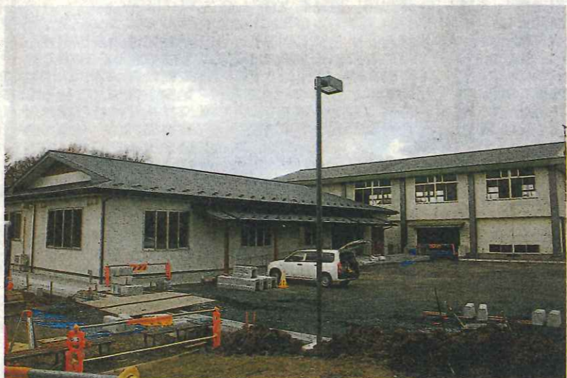
3月初旬ごろのオープンに向け順調に工事が進む亀ヶ崎コミセン。手前がコミセン、右奥は既設の記念会館＝昨年12月末
